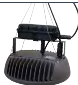
Kit di emergenza installato Emergency kit installed
